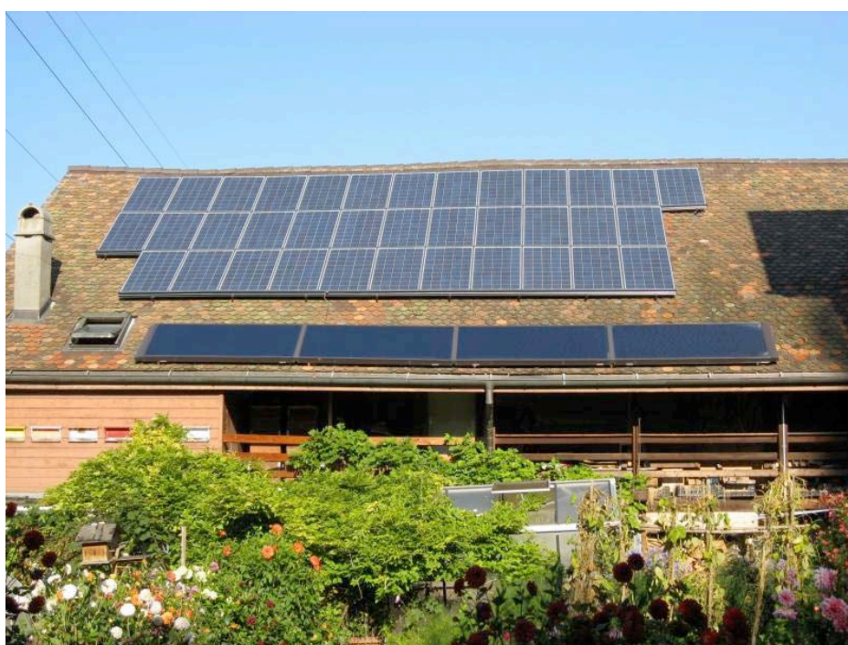
Figure 6: Panneaux photovoltaïques (en haut) et thermiques (en bas)
